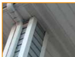
Angle et ventilation
